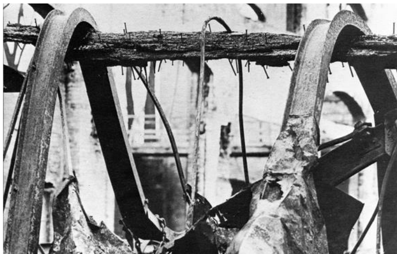
Figura 1. Elementos de madeira e de aço pós-incêndio (Ritter, 1990).
