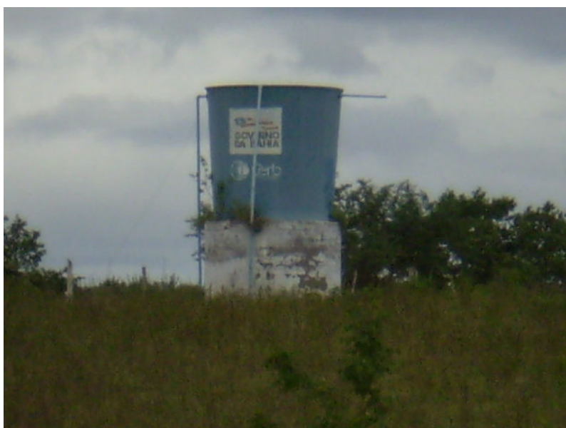
Foto 20 –Caixa de distribuição de água – Ilha de São Gonçalo – BA, 2007.
