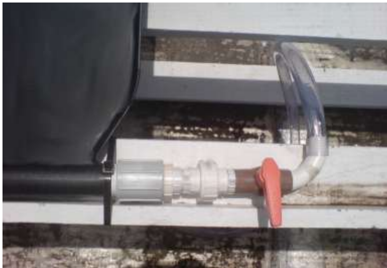
Figura 3.5 – Detalhe do sistema de acoplamento nos coletores solares avaliados.
