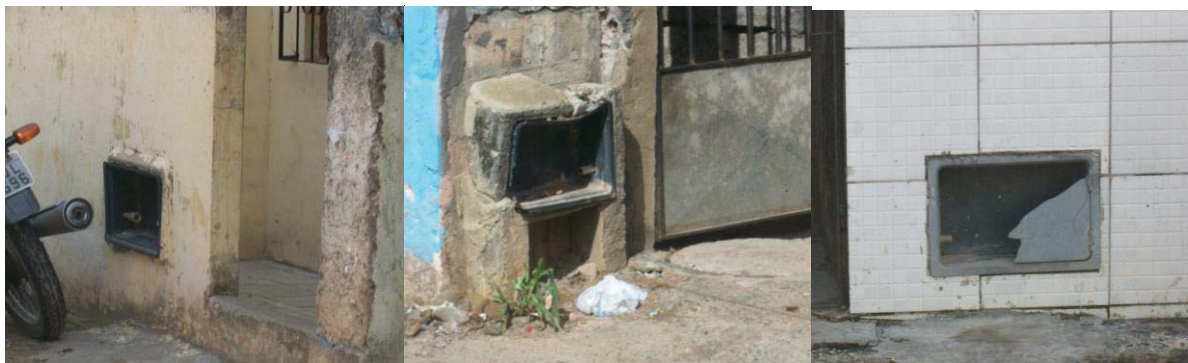
Figura 20. Fotos do cavalete onde o abastecimento de água foi cortado e o hidrômetro retirado
