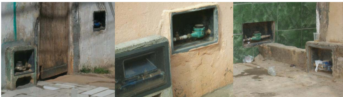
Figura 21. Fotos de hidrômetros instalados na rua onde foi realizada a pesquisa
