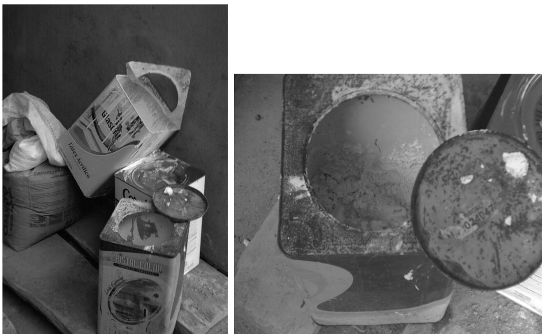
FIGURA 11: Armazenamento inadequado de embalagens de tintas com resíduos em canteiro de obras de um edifício de médio porte em Salvador – BA (novembro de 2006). Fonte: fotografado por Valnêr Guimarães Junior
