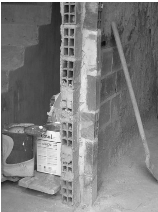
FIGURA 12: Armazenamento inadequado de embalagens de tintas com resíduos, em canteiro de obras de um edifício em Salvador-BA. (novembro de 2006).
