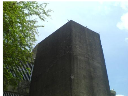
12 - Reservatório elevado REL3
