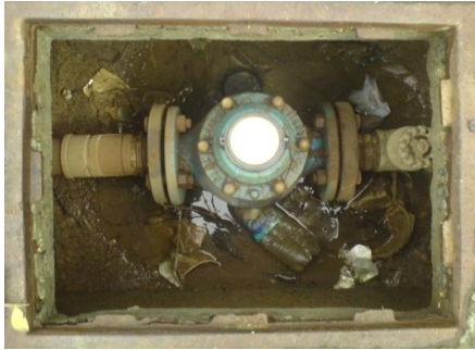
21 - Hidrômetro antes da manutenção
