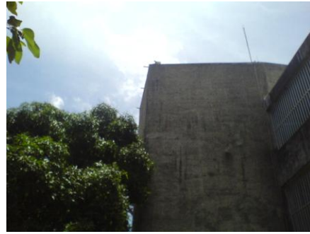
8 - Reservatório elevado REL1
