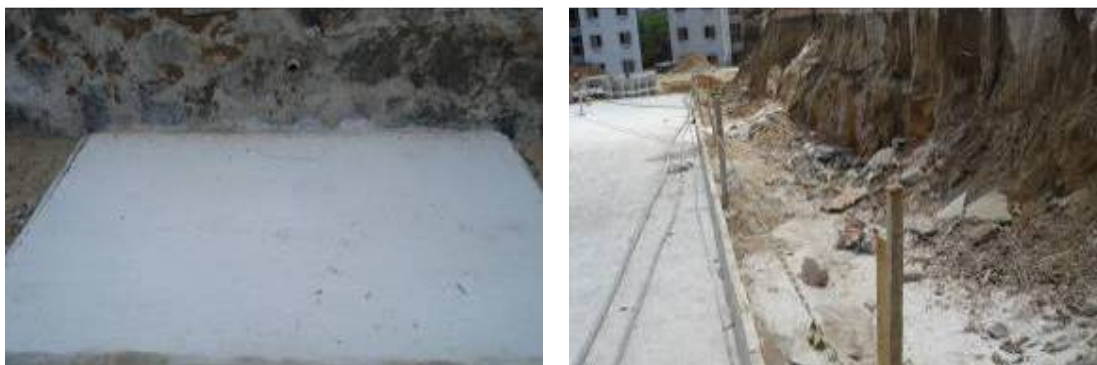
Figura 40 Concreto magro com agregados reciclados – Estudo de Caso 2
