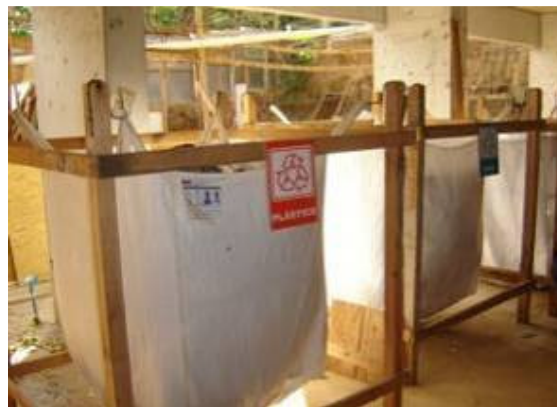
Figura 20 Dispositivos para segregação de RCC – Estudo de Caso 1
