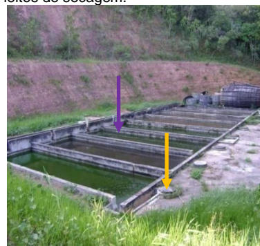
Figura 9(d) – Leitos de secagem e PV's instalados sobre o emissário.
