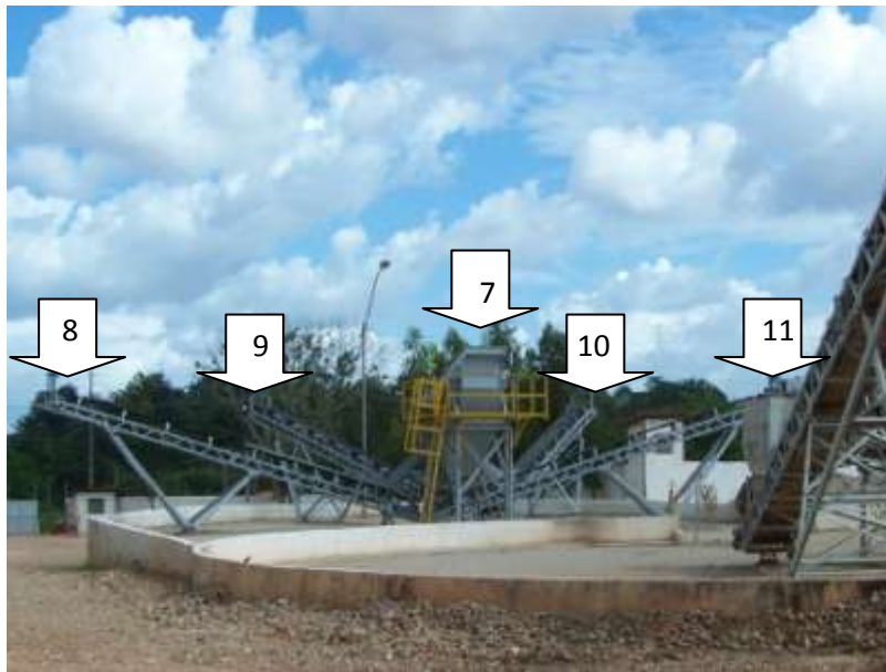
Figura 46. Peneiras Vibratórias – PVA (7), Transportador de Correia Fixo – TCF3 (8), Transportador de Correia Fixo – TCF4 (9), Transportador de Correia Fixo – TCF5 (10), Transportador de Correia Fixo – TCF6 (11). Usina “B”
