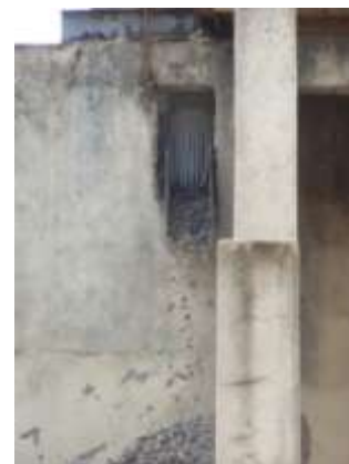
Figura 71. Queda do agregado reciclado de concreto - Usina "C".
