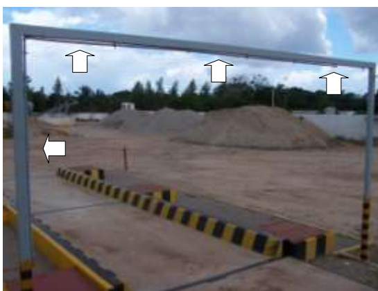
Figura 13. Dispositivo de molhagem da usina “B” instalado na área de acesso da balança.
