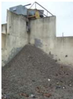
Figura 70. Vista anterior da baia - Usina "C".
