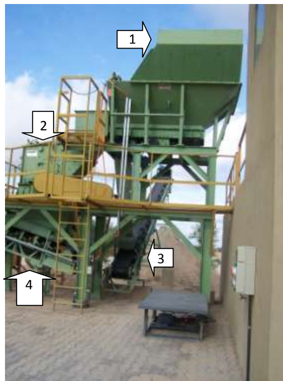
Figura 42. Alimentador Vibratório – AV (1), Britador de impacto – BI (2), Transportador de Correia Fixo – TC 1 (3), Transportador de Correia Fixo – TCF2 (4). Usina “A”
