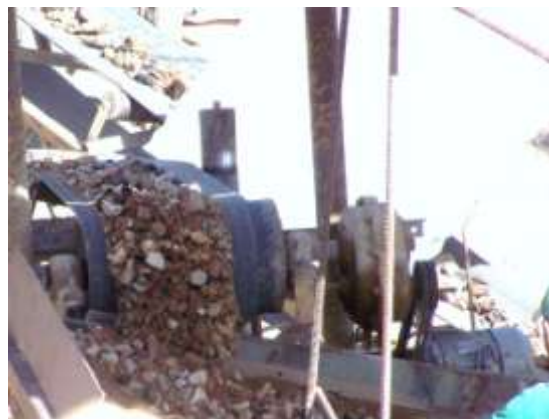
Figura 37. Descontinuidade na alimentação da bandeja de vibração do britador.
