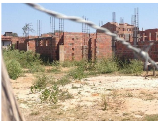
Foto 6 – Obra inacabada da Creche do bairro Cidade Nova . Data: 10/10/2014 Fonte: http://www.valtervieira.com.br/noticia/bahia/40304/serrinha-obras-abandonadas-de-creches-comprometem-atividades-escolares-no-municipio
