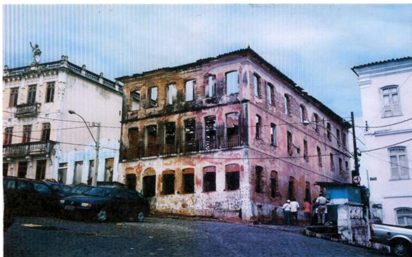
Figura 43: Ruína no Largo da Palma, onde viria a se instalar o hotel A Casa das Portas Velhas, 2002
