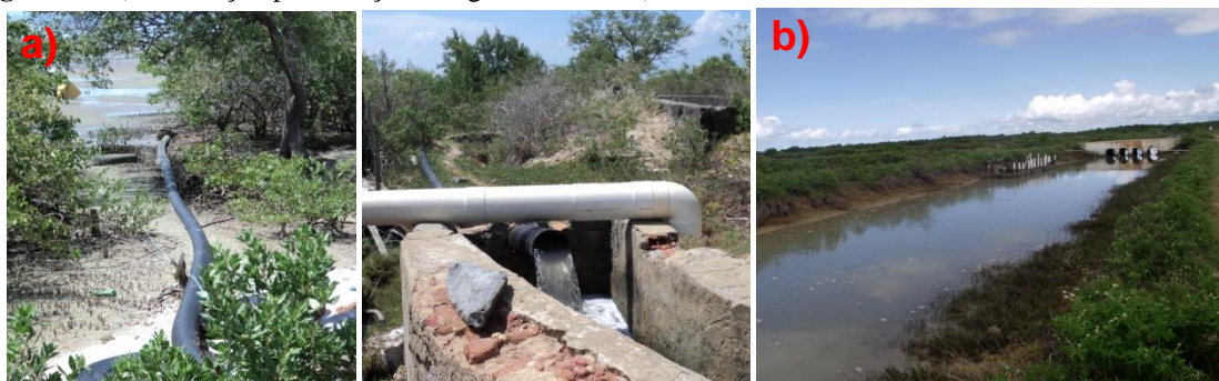
Figura 59. a) Tubulação para sucção de água do mar e b) canal de abastecimento
