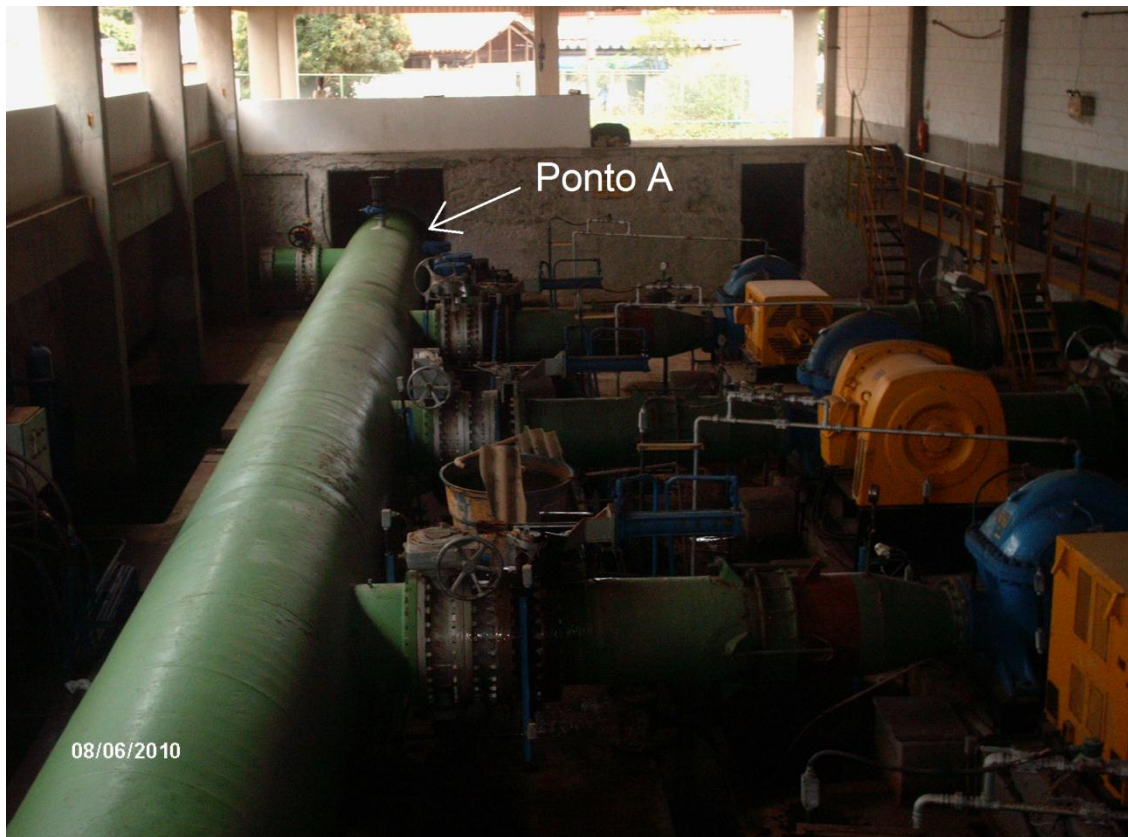
Figura 2.8 – Detalhes do ponto de descarga da linha adutora. Prédio da estação de bombeamento Alta Carga (é possível ver três bombas das quatro da instalação, e os ramais de conexões das bombas com a linha adutora principal)
