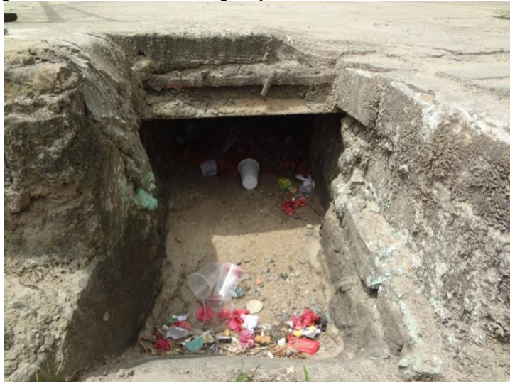
Figura 24: Canaleta de drenagem pluvial com lixo, São Félix - Bahia
