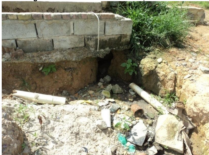
Figura 10: Rede de esgotamento sanitário a céu aberto, S. Francisco do Conde – Bahia.
