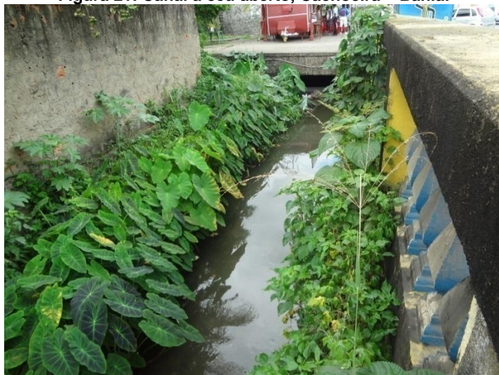
Figura 21: Canal a céu aberto, Cachoeira – Bahia.
