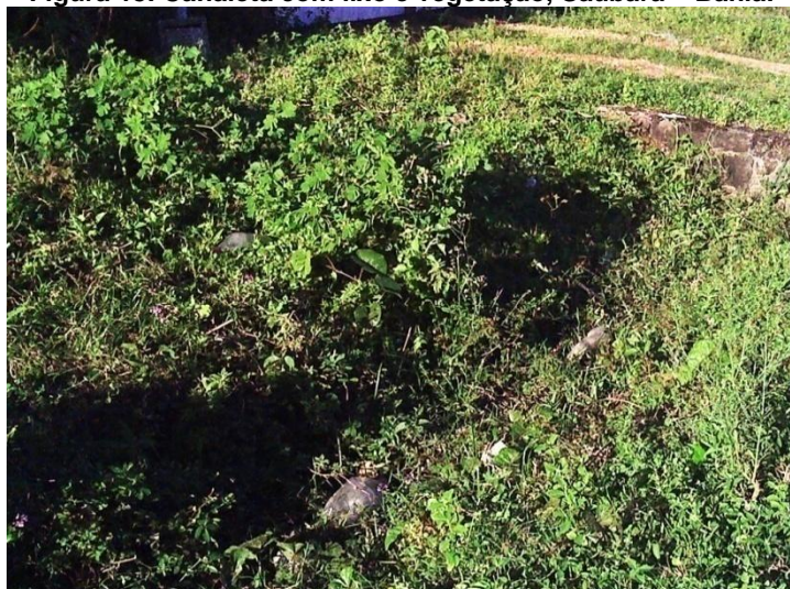
Figura 18: Canaleta com lixo e vegetação, Saubara – Bahia.
