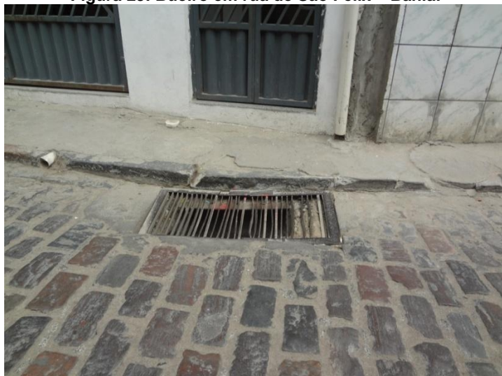
Figura 23: Bueiro em rua de São Félix – Bahia.
