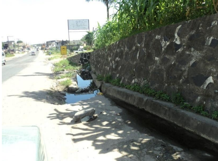
Figura 6: Canaleta superficial deteriorada, Candeias – Bahia.
