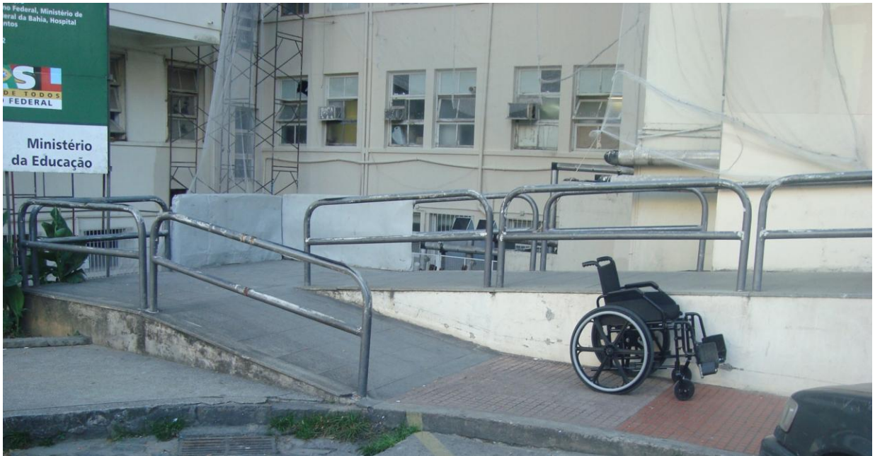
Fig 04: Rampa de acesso ao hospital, com guarda corpo e corrimão em estado precário de conservação. Exemplo de barreira física e atitudinal: veículo estacionado no local da rampa de acesso do estacionamento para a calçada (não visualizada) impossibilitando a sua utilização.
