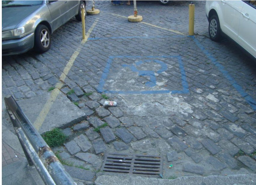
Fig. 02: Pavimentação com irregularidades no assentamento dos paralelepípedos e desnivelamentos que dificultam o acesso e mobilidade de cadeirantes e de outros usuários ao HUPES. Aspecto da vaga de estacionamento preferencial para cadeirantes.
