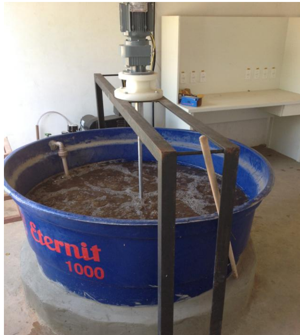
Figura 9 - ETE Piloto instalada
