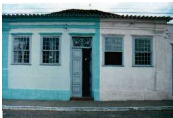
Figura 8: Desmembramento de fachada. Foto: Natália Naoumova.
