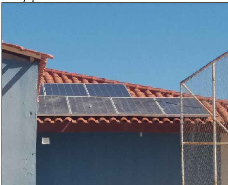
Figura 29 - Equipamentos vandalizados no Centro Comunitário Morada do Salitre
