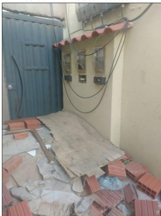
Figura 30 – Exemplo ilustrativo do estado dos quadros de medidores em uma unidades dos condomínio Praia do Rodeadouro
