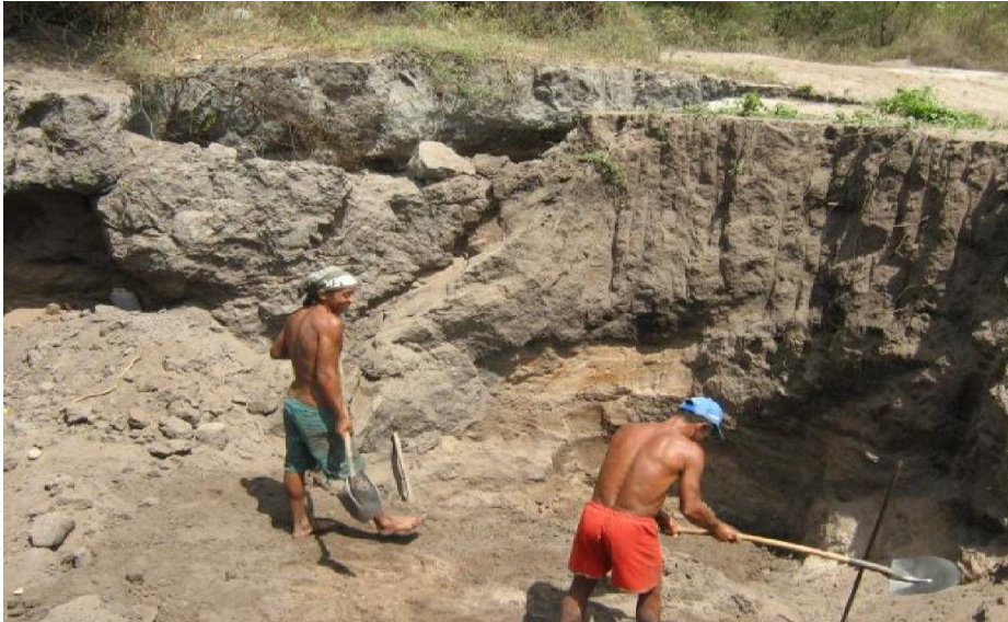
Figura 6 – Trabalhadores extraíndo material sem equipamento de segurança
