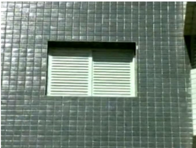
Fig. 7: Janela sem a rede de proteção
