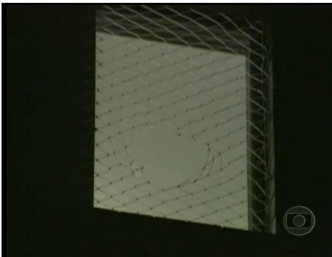
Fig. 3: Rede de proteção cortada
