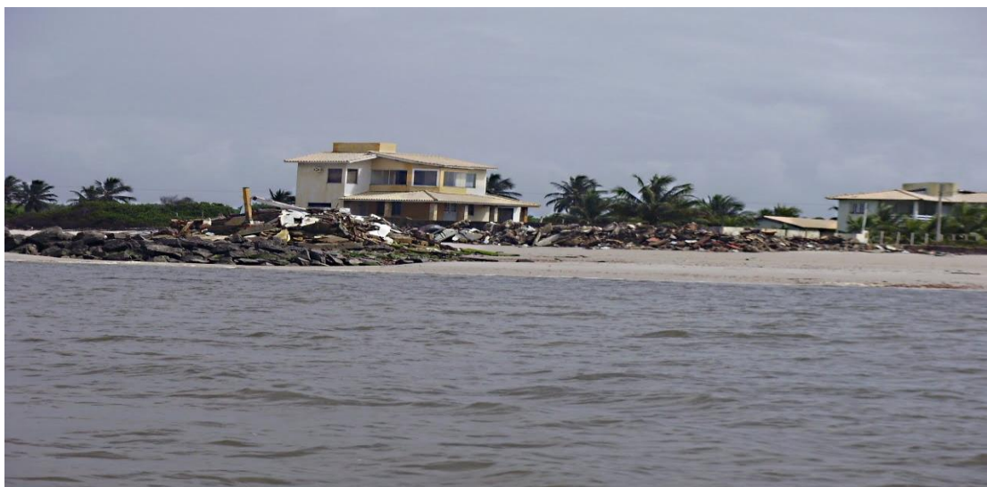
Imagem 5: Casas construídas de frente para o mar na praia do saco comprometidas como o avanço do mar. Fonte: http://luiztrigo.blogspot.com.br/2010/07/praiado-saco-sergipe-mare-destruidora.html
