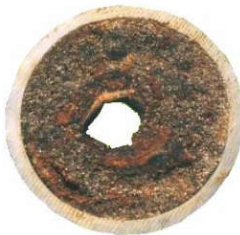
Figura 1 – Deposição de parafinas e outros sólidos na parede interna da tubulação
