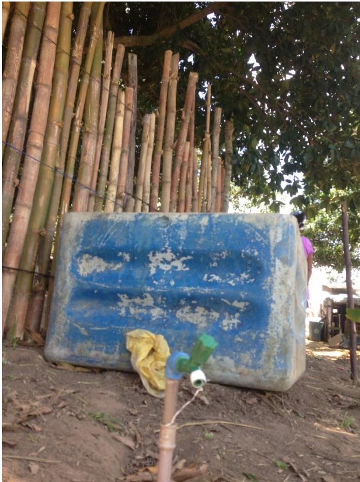
Foto 71: Infraestrutura para irrigação da horta
