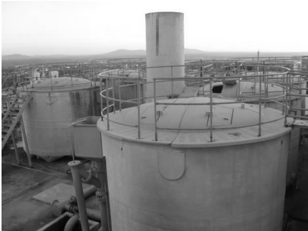
Figura 2 - Filtros Ascendentes da ETA de Palmeira dos Índios
