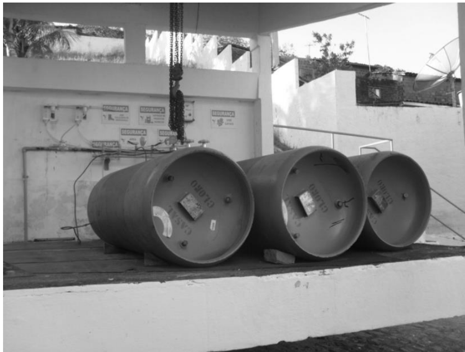
Figura 8 - Sistema de Cloração da ETA de Palmeira dos Índios
