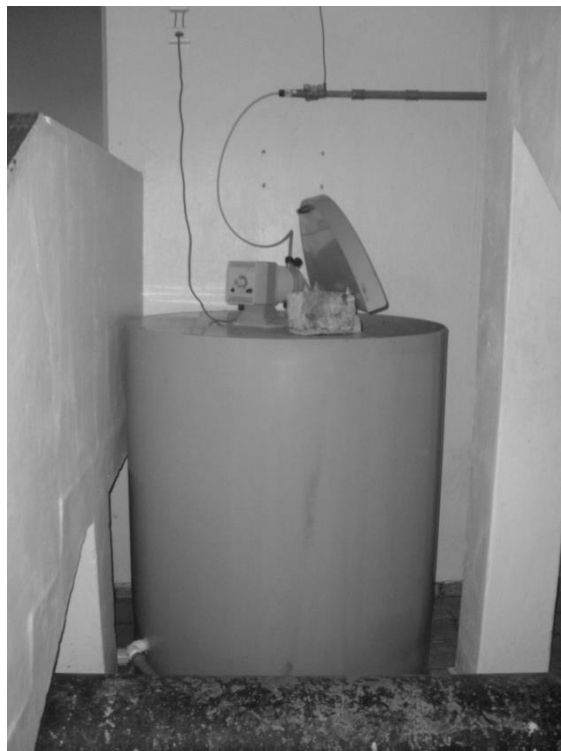
Figura 4 - Reservatório Interno de Sulfato Líquido
