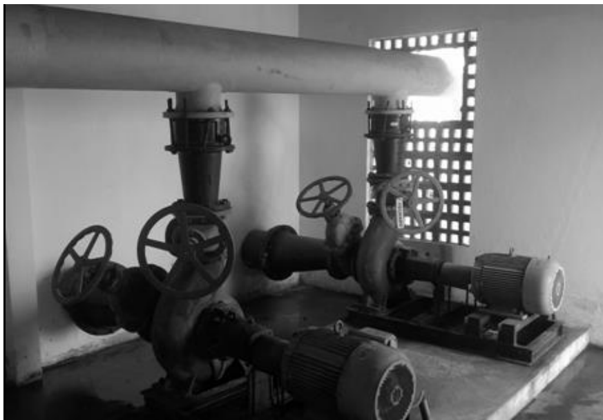
Figura 6 - Conjuntos Motobombas de Lavagem dos Filtros de Fibra da ETA
