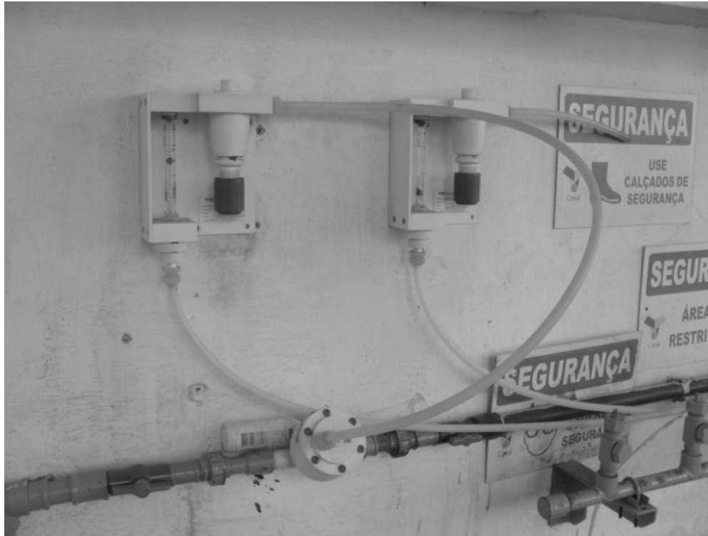
Figura 9 - Válvulas de Controle Manual do Sistema de Cloro
