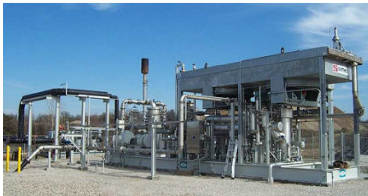
Figura 13 – Estação de tratamento de biogás
