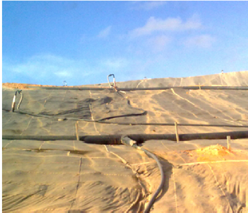
Figura 17 – Geomembrana usada no aterro sanitário de Salvador Fonte: Nápravník Filho (2009)
