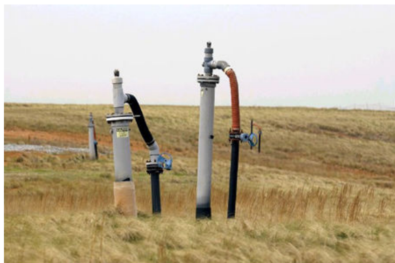
Figura 12 – Cabeçote de dreno de biogás Fonte: USEPA (2011)
