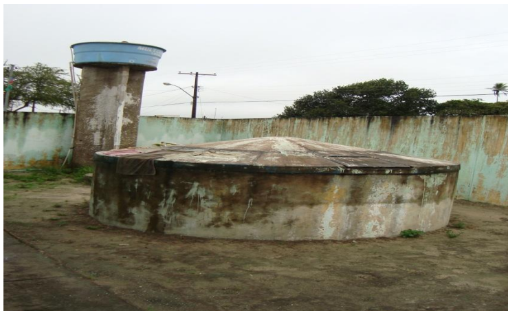
Fotografia 26. Cisterna e tanque de água potável
