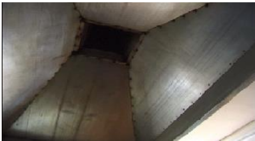
Figura 3.40 - Exaustor industrial na cozinha da Zanon (29:40).
