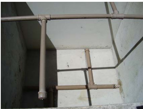
Vista do interior do filtro sem areia, visualizando o sistema interno de coleta do efluente, ao fundo, e o primeiro de distribuição tentado.
