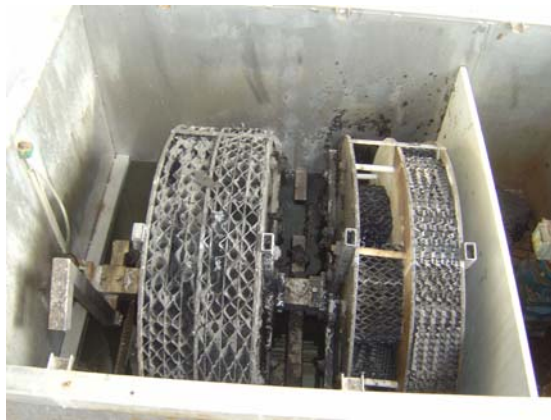
Vista do CBR com as colméias quebradas, já fora de operação.
