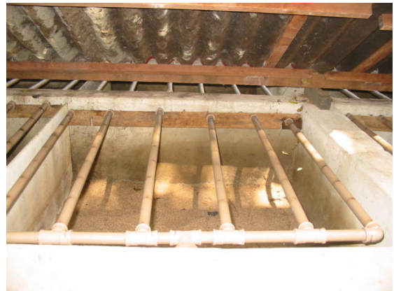
Vista do sistema de distribuição de um filtro de areia.
