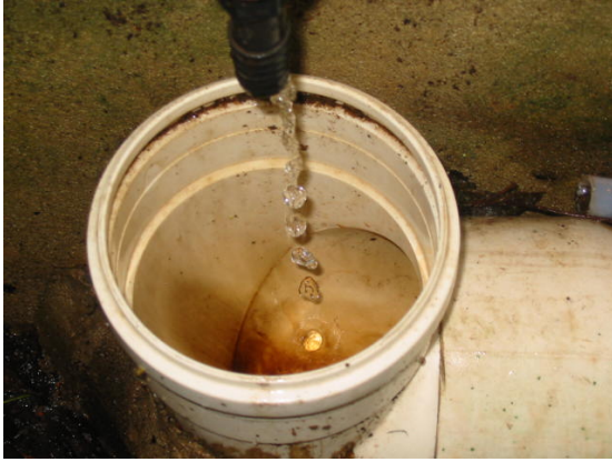
Vista da saída do efluente de um filtro.
