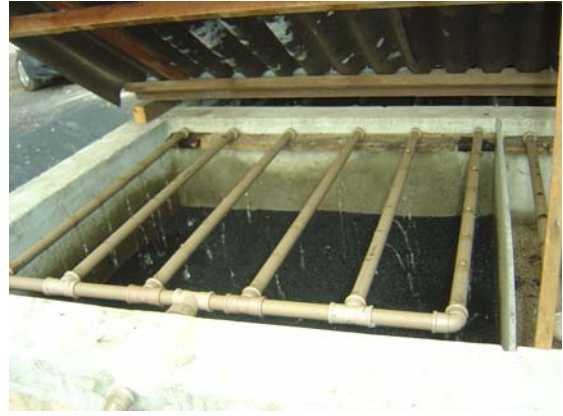
Vista do sistema de distribuição de um filtro de escória.
