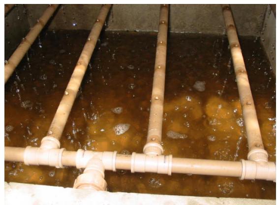
Vista superior de um filtro colmatado recebendo esgoto, já inundado.
