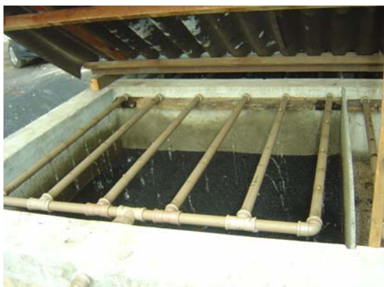
Figura 3.15 – Vista do sistema de distribuição do afluente do filtro 12
