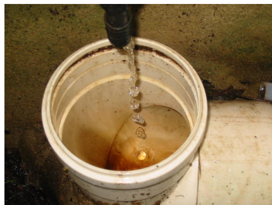
Figura 3.16 – Vista do efluente de um dos filtros.
