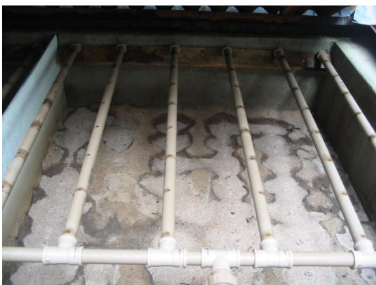
Vista superior do filtro no início da colmatação.
