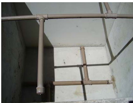
Figura 3.14 – Vista do sistema de drenagem do filtro, no fundo deste. Em cima o primeiro sistema de distribuição experimentado, depois modificado, como mostrado na figura anterior.
