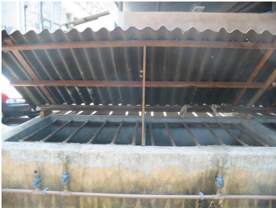
Vista de uma das câmaras de 1m de largura por 2m de comprimento com 1m de altura e subdivididas em duas com placas de fibro-cimento perfazendo dois filtros com entradas e saídas independentes.
