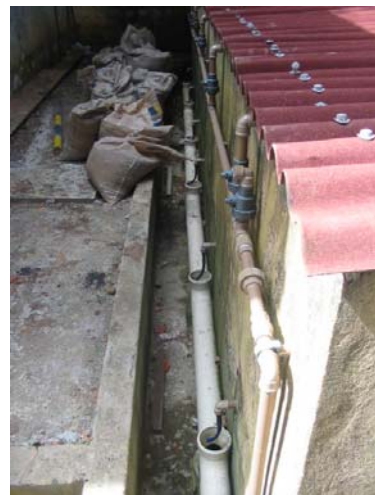
Vista lateral da estação com a tubulação de coleta dos efluentes dos filtros.
