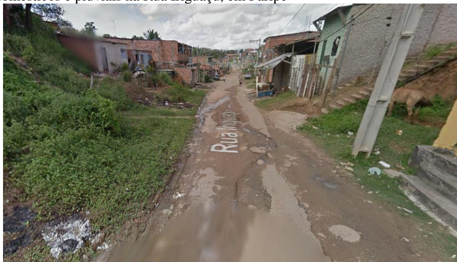
Figura 40 - Falta de esgotamento sanitário e de bueiros para escoar os resíduos domésticos e pluviais na Rua Iriguaçu, em Paripe
