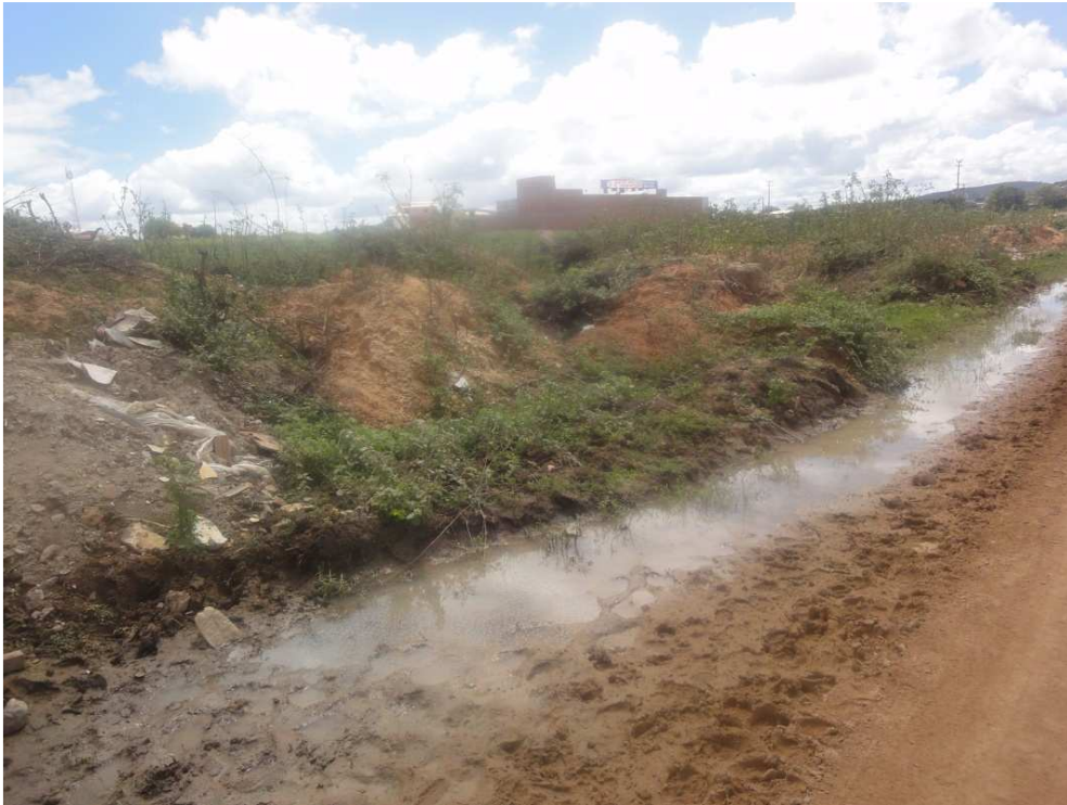
Figura 25 – Acúmulo de água em via de acesso (aterrada) ao bairro Catuaba, localizado em área úmida
