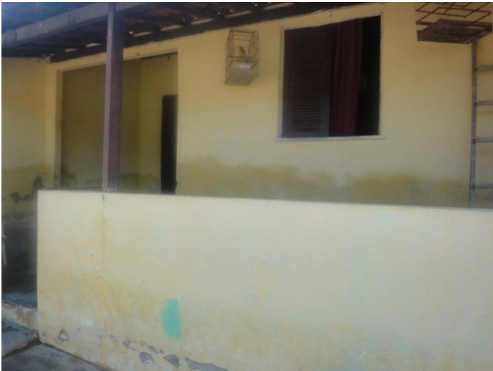
Figura 24 – Casa construída em aterro sobre área úmida, bairro Catuaba; observa-se a ascendência de umidade nas paredes
