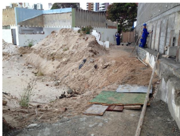
Figura 37: Buraco no solo perto da área a revestir (Fonte: O autor)
