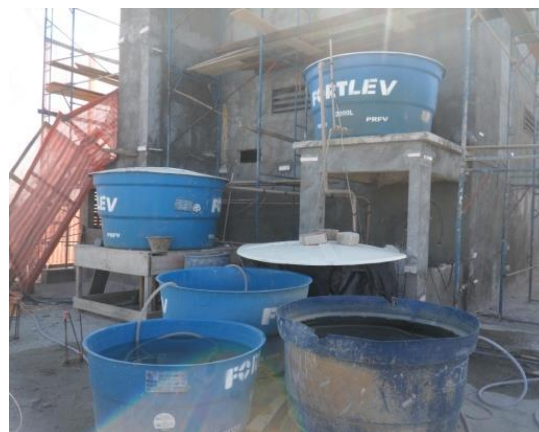
Figura 18: Reservatório de água situado na cobertura (Fonte: O autor)
