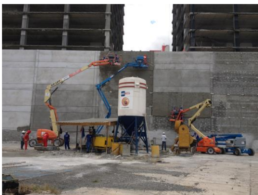
Figura 33: Silo e plataformas áreas (Fonte: O autor)
