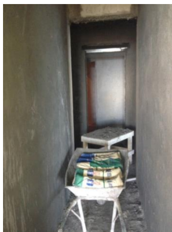
Figura 79: Um banco situado na via de acesso dificulta o transporte da argamassa com o carrinho de mão (Fonte: O autor)
