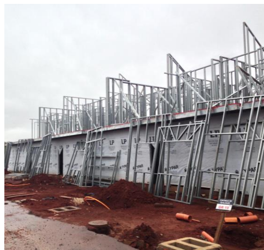
Figura 102: Instalação dos frames do primeiro andar após instalação da membrana hidrófuga no térreo (Fonte: O autor)
