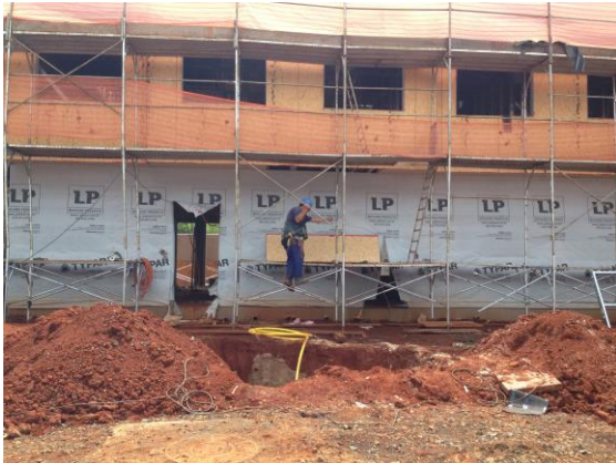
Figura 115: Trabalhador se pendurando para evitar a escavação encontrada na área de trabalho (Fonte: O autor)
