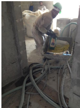
Figura 77: As mangueiras no chão dificultam o transporte da argamassa com o carrinho de mão (Fonte: O autor)
