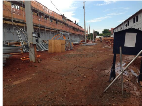
Figura 111: Cabo atravessando a via acesso (Fonte: O autor)
