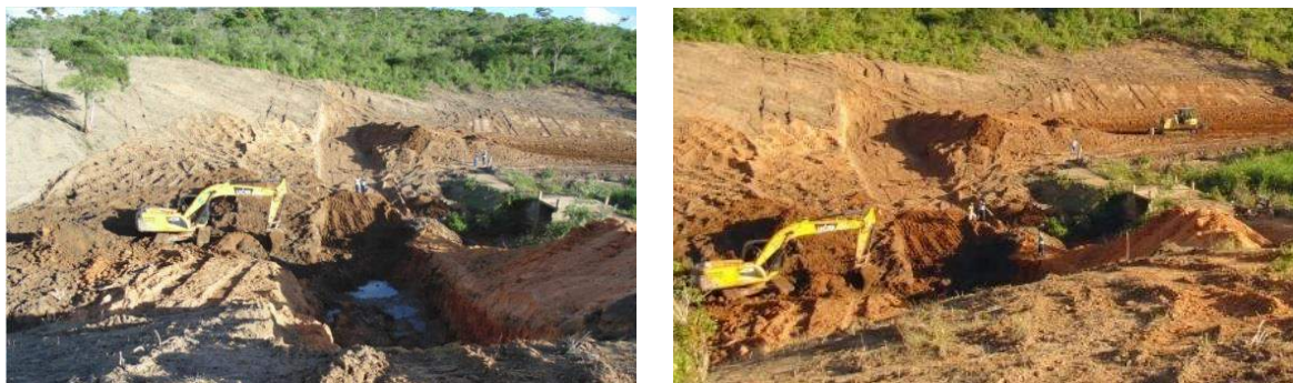
Figura 36 – Prefeitura de Lajedo do Tabocal: Construção e limpeza de aguadas, abertura de poços tubulares e construção de cacimbas na zona rural do município
