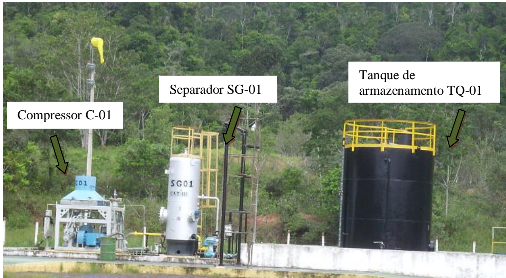
Figura 15 – Estação de processamento primário do poço 1-FMO-001-BA.
