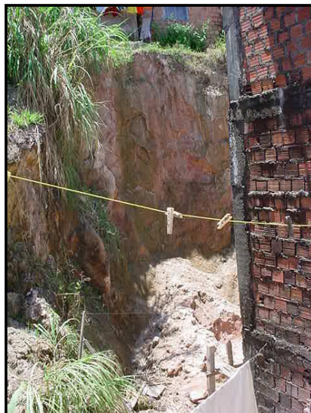
Foto 1 - Deslizamento de terra no bairro de São Marcos - Salvador-BA Fonte: France Dielle de F. Fonseca (arquivo pessoal), 2005.
