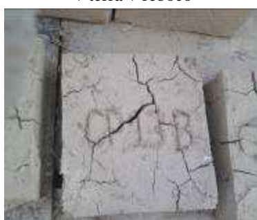
H Detalhe das rachaduras
