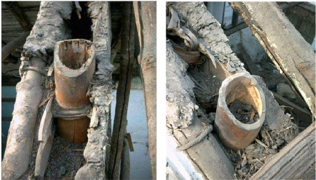
Figura 35 Detalhe da durabilidade do bambu em paredes antigas de Guadua angustifolia Fonte: Grupo (2010)
