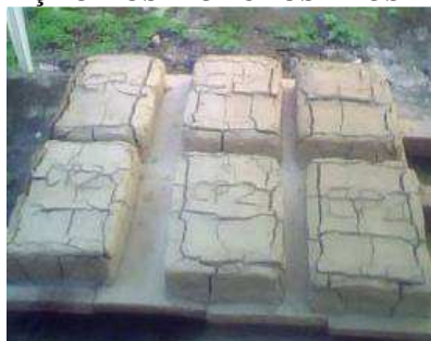
A Rachaduras após a 4ª semana
