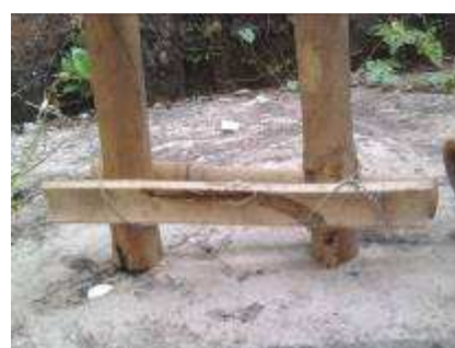
I Detalhe de ataque do cupim no entramado inicialmente atacado pela broca
