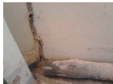
I Ataque de cupim em montante exposto
