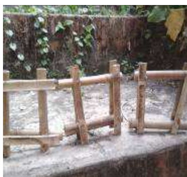
B CP 09 A, B e C – Entramado de Bambu com broca e cupim
