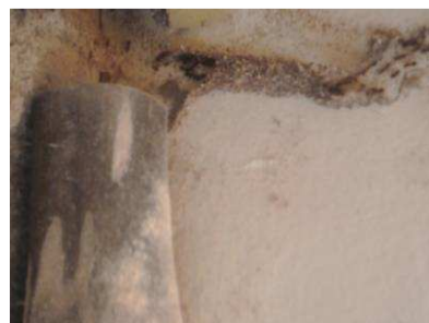
H Detalhe de ataque de cupim em montante exposto
