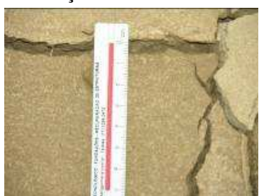
A Detalhe da rachadura média de 0,7cm
