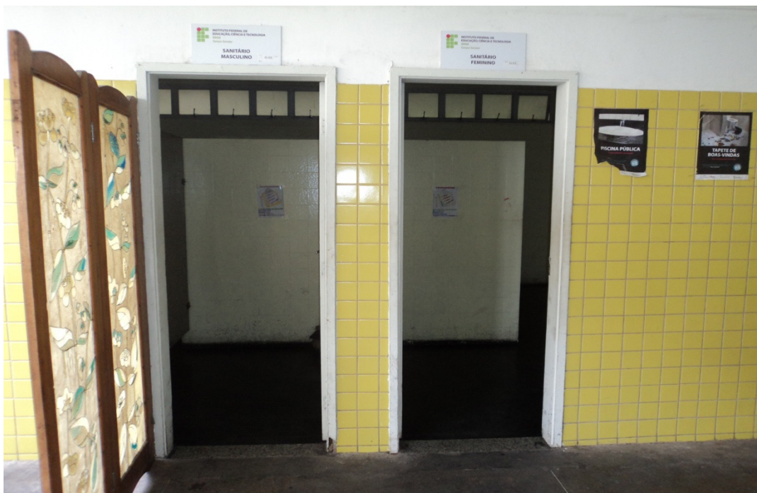
Figura 13 - Sanitários próximos ao Auditório Principal – não acessíveis
