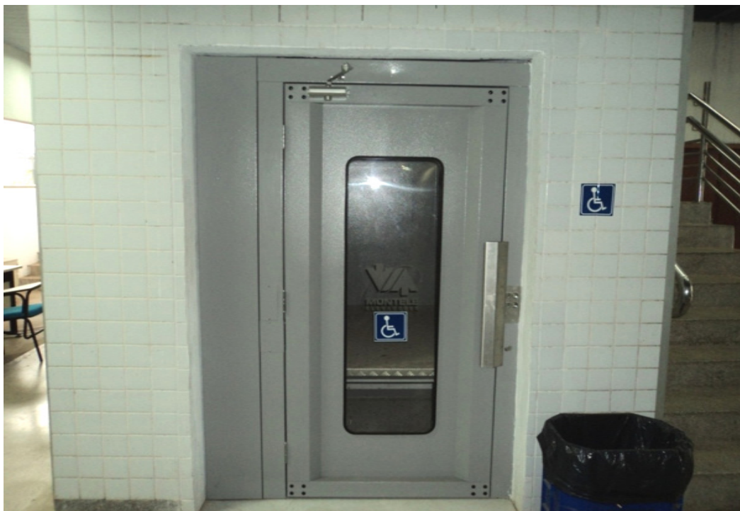
Figura 7 - Elevador do Bloco L – sem funcionamento
