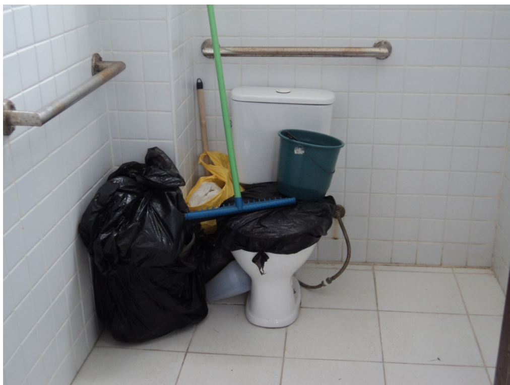
Figura 14 - Banheiro feminino acessível do Bloco D - interditado
