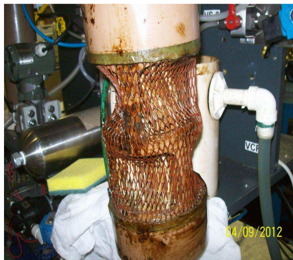
Figura 28 – Aspectos do sistema de MF antes do início do processo de limpeza química - módulo das membranas
