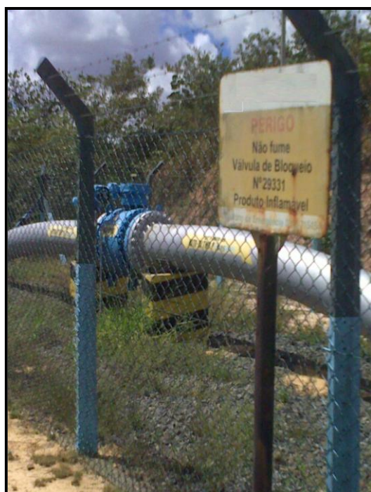
Figura 16: Estação de Válvula da comunidade de Pitanga dos Palmares Fonte: Diagnóstico Socioambiental, 2012.
