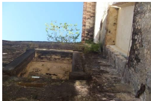
Figura 53 – Penetração de raízes: lado posterior esquerdo à fachada principal.
