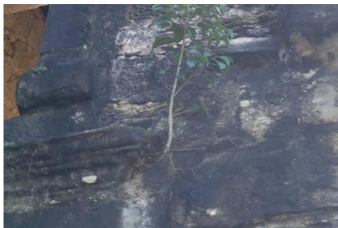
Figura 52 – Penetração de raízes: lado posterior direito à fachada principal.
