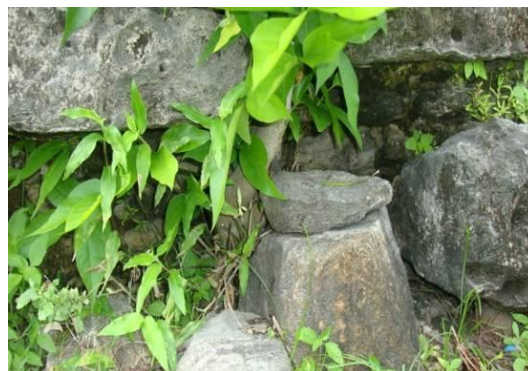
Figura 80 – Penetração de raízes: base da cortina norte.
