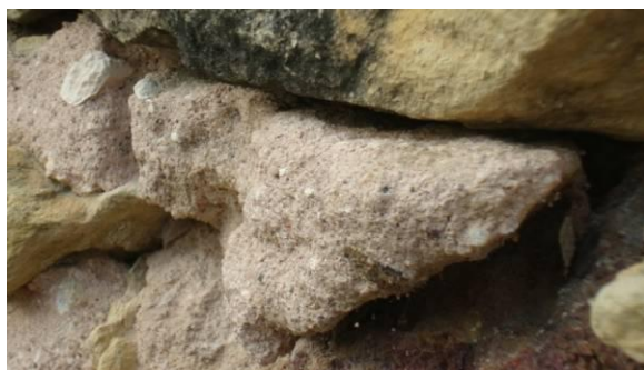
Figura 55 – Desestabilização de alvenarias: base da parede da fachada leste.
