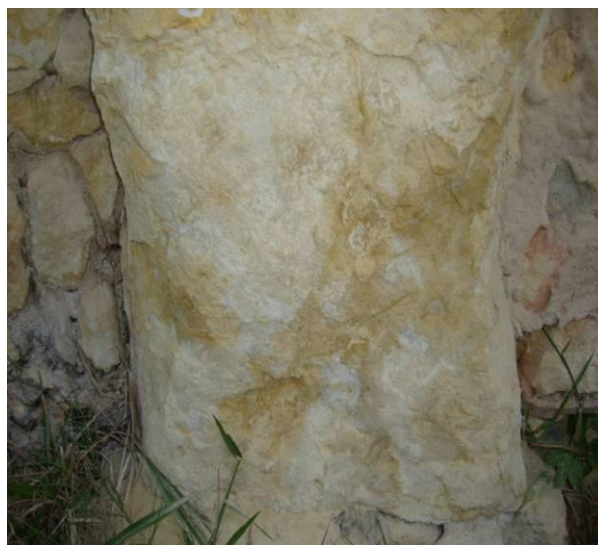
Figura 13 – Desagregação. Pilar da Igreja do Almagre. Cabedelo-PB.
