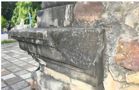
Figura 51 – Perdas: parte anterior da imposta do lado direito da fachada principal.
