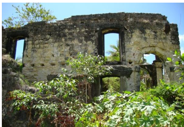
Figura 69 – Penetração de raízes: fachada oeste.
