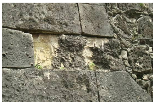
Figura 77 – Desagregação: cunhal da cortina norte.
