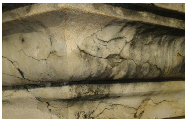
Figura 58 – Recuperação com materiais inadequados: parte frontal da imposta central.
