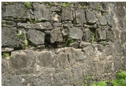
Figura 81 – Desestabilização de alvenarias: cortina norte.
