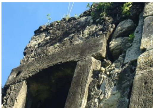
Figura 65 – Degradação diferencial: portal superior da fachada principal.
