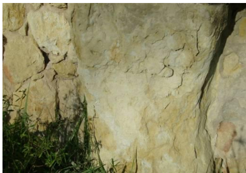
Figura 67 – Desagregação: pilar da fachada oeste.
