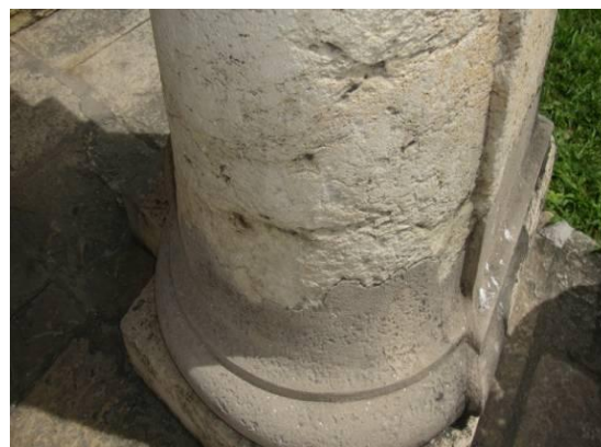
Figura 83 – Recuperação com materiais inadequados: descolamento do reparo.
