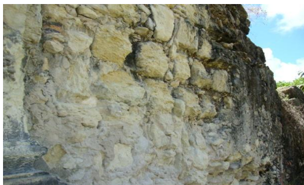
Figura 71 – Recuperação com materiais inadequados: parede da fachada oeste. Fonte: Paulo Germano Toscano Moura (2011).
