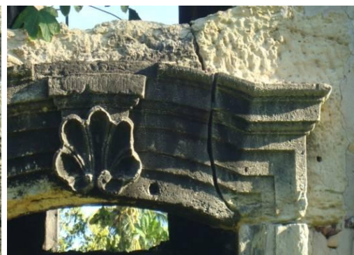
Figura 66 – Degradação diferencial: portal de entrada da fachada principal.
