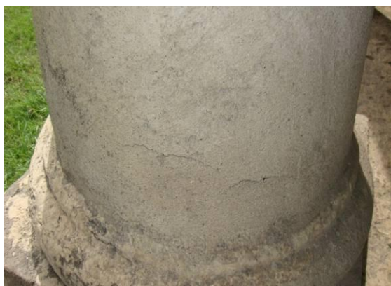
Figura 82 – Recuperação com materiais inadequados: fissuras de retração do reparo.
