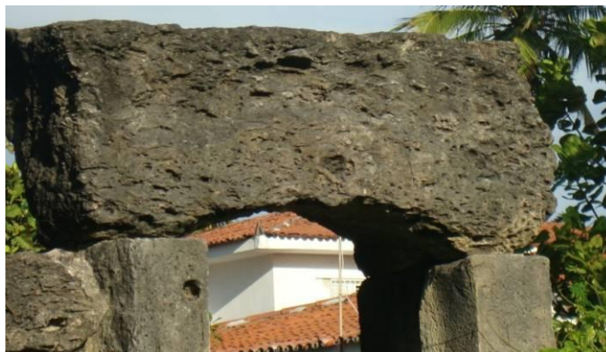
Figura 62 – Alveolização: ruínas da parte posterior da construção.
