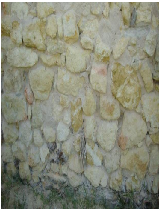
Figura 60 – Alteração cromática: fachada leste.
