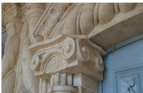
Figura 50 – Perdas: parte superior do capitel da cercadura na fachada principal.
