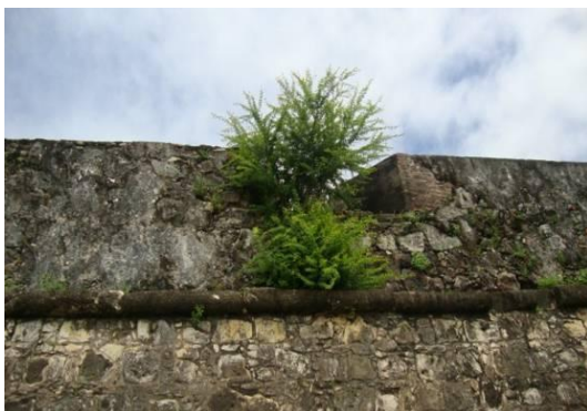
Figura 79 – Penetração de raízes: coroamento da cortina leste.
