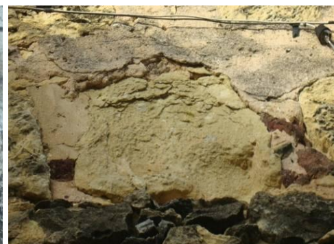
Figura 49 – Esfoliação: fachada sul, base da parede
