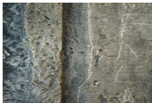
Figura 45 – Alveolização: portal da fachada posterior, à fachada principal
