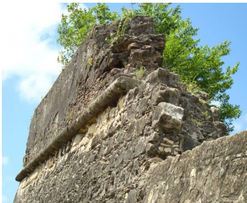
Figura 2 – Desmoronamento do coroamento da parede (Fortaleza de Santa Catarina, Cabedelo-PB). Fonte: Paulo Germano Toscano Moura (2011).
