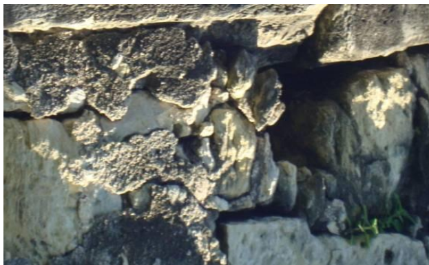
Figura 70 – Desestabilização de alvenarias: base da parede da fachada oeste. Fonte: Paulo Germano Toscano Moura (2011).
