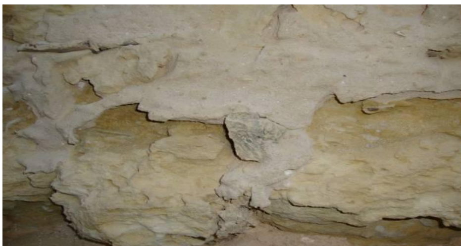
Figura 15 – Esfoliação. Base de pilar da Igreja do Almagre, Cabedelo-PB. Fonte: Paulo Germano Toscano Moura (2011).
