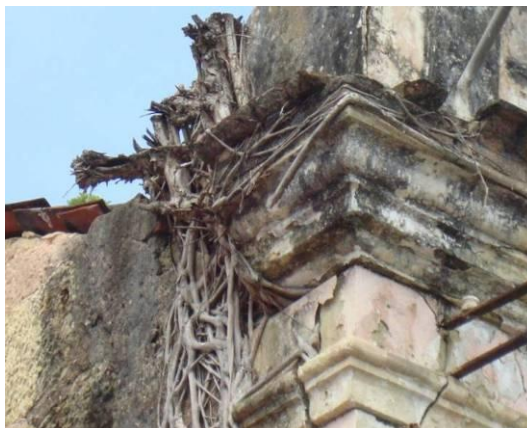
Figura 7 – Efeitos destrutivos de plantas e expansão corrosiva de metais, em fachada de pedra. Edifício na Rua Duque de Caxias, João Pessoa. Fonte: Paulo Germano Toscano Moura (2009).
