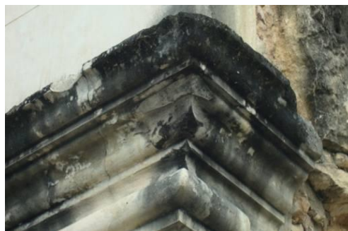
Figura 47– Biofilme: imposta do canto esquerdo da fachada principal
