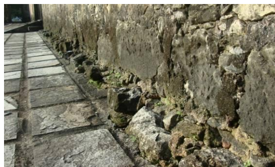
Figura 56 – Desestabilização de alvenarias: base da parede da fachada oeste.
