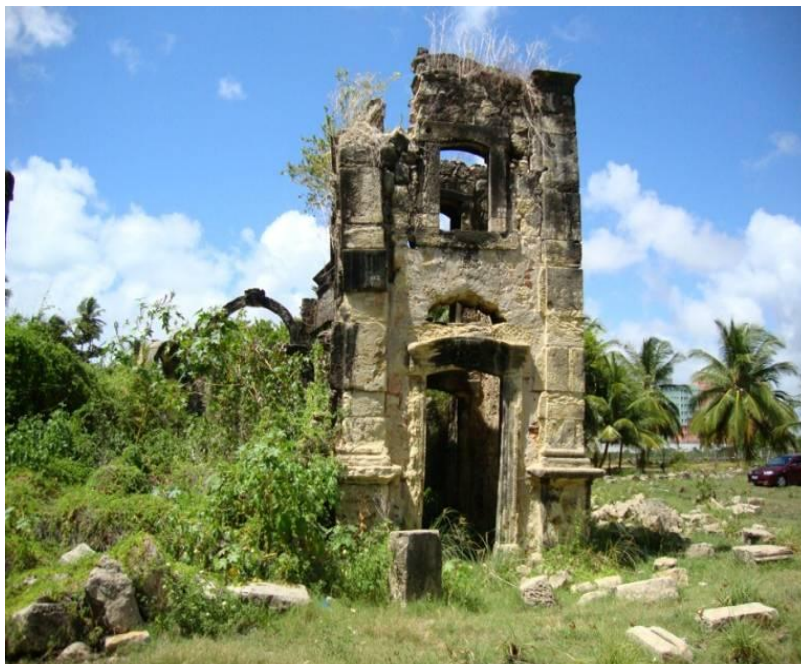
Figura 3 – Rotação de muros (Igreja do Almagre, Praia do Poço, Cabedelo-PB). Fonte: Paulo Germano Toscano Moura (2011).
