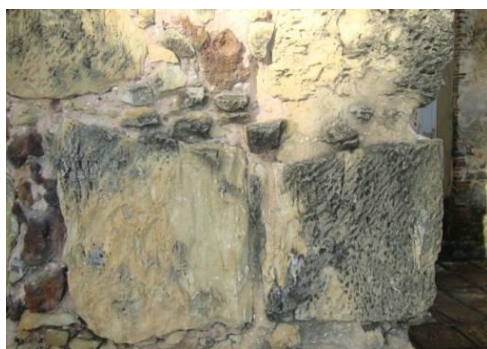
Figura 44 – Alveolização: base da parede, fachada sul
