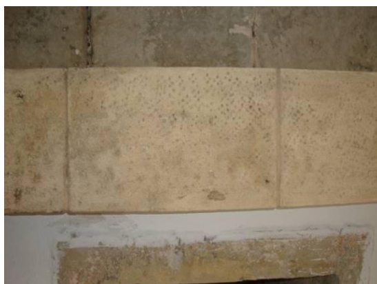
Figura 78 – Pitting: galeria de entrada da fortificação.
