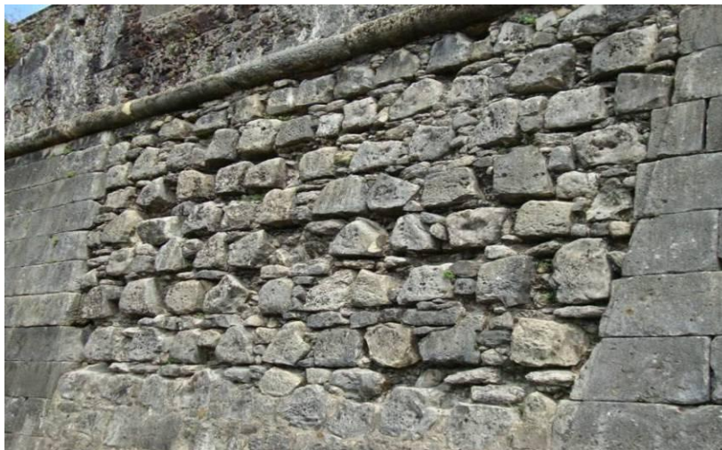
Figura 1 – Trecho de alvenaria bruta, entre cunhais, com perda considerável da argamassa de assentamento das pedras. (Fortaleza de Santa Catarina, Cabedelo-PB). Fonte: Paulo Germano Toscano Moura (2011).
