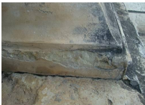
Figura 48 – Esfoliação: base da coluna do lado esquerdo da fachada principal
