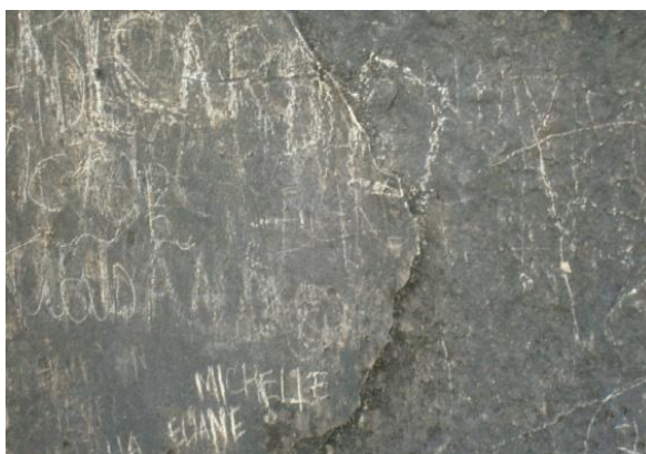
Figura 54 – Dilapidação provocada por inscrições: fachada norte, base da parede.
